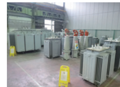
黒部事業所 微量PCB含有機器保管庫
