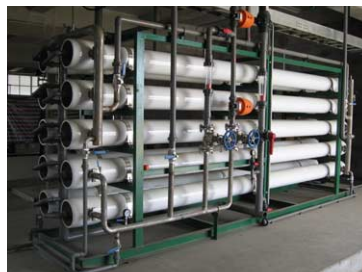
YKK深圳社 公明工場 ファスナー染色排水の80%を回収し、染色用水として再利用しています。 (2007年稼働開始)
