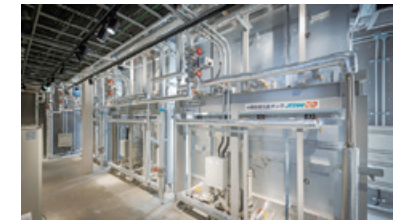
Power to Gas機械室(水素吸蔵合金タンク)
