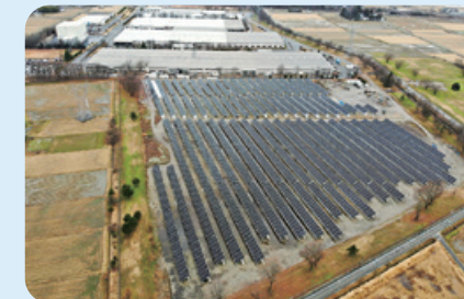
YKK AP滑川製造所に導入した 太陽光発電(両面発電パネル+高反射防草シート)
