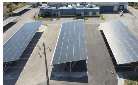
On-site solar PV systems (YKK Portugal - Acessorios Para Vestuario LDA.)
