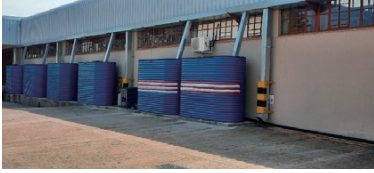
工場屋上を利用した集水（YKKサザン・アフリカ社）
