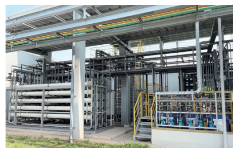
水リサイクル施設（YKKベトナム社ハナム工場）
