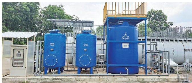
水循环利用设施（YKK印度尼西亚公司）
