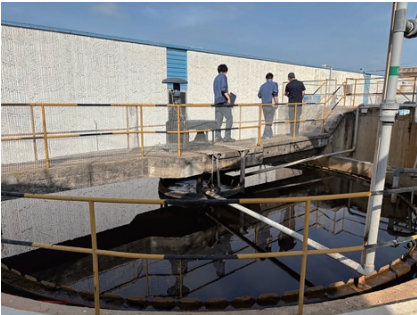
污水水处理诊断：YKK西班牙公司塔尔图斯工厂
