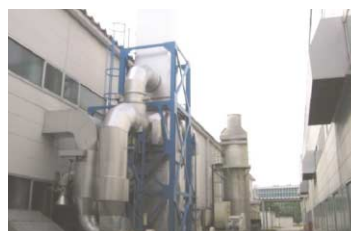
ファスニング事業本部の塗装後排ガス燃焼塔
