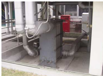
既設屋外熱交換器
