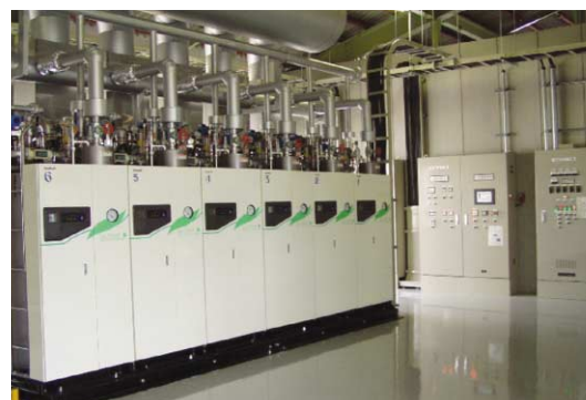
LPG焼き高効率小型貫流ボイラー 6基
