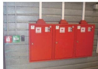
火災排煙装置
