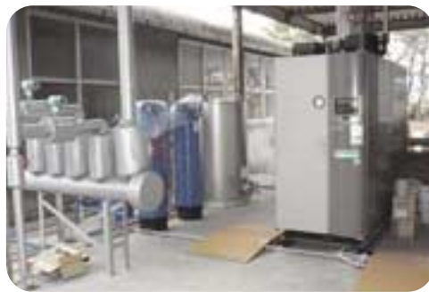
ボイラーの燃料転換（重油→天然ガス）
