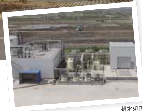
排水処理設備&リサイクル設備
