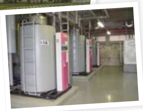
高効率貫流ボイラー
