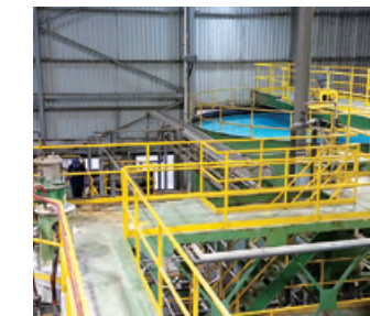
ダブリン工場の排水処理システム
