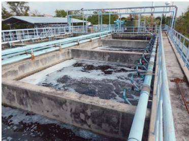
YKKタイ社での排水処理診断の様子
