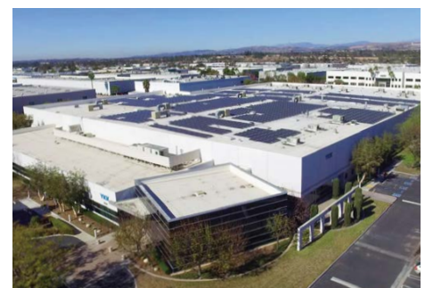
太陽光発電設備の設置事例 YKK U.S.A.社 アナハイム工場
