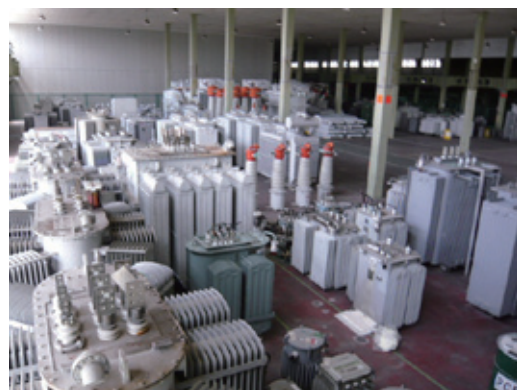
黒部事業所低濃度PCB保管庫
