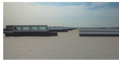
屋根には自然採光の窓(トップライト)も設置
