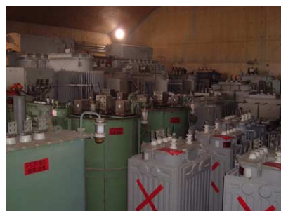
微量PCB含有機器専用保管庫
