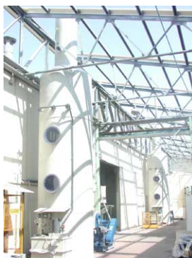
水酸化ナトリウム溶液によりシアン化水素ガスを中和処理する浄化装置を2機設置(YKKメディテラオ社)
