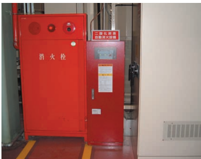
ダクト火災予防用の消火設備 (中央)
