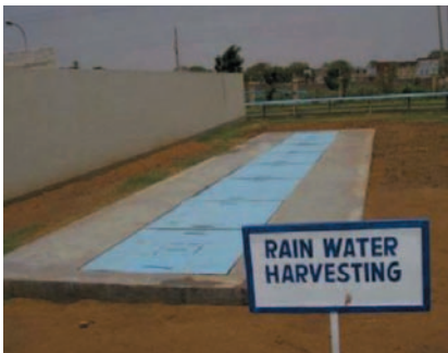
インド社の雨水回収装置
