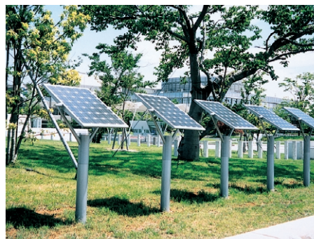
黒部工場 太陽光発電システム
