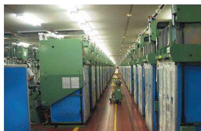
作業エリアのみを点灯
