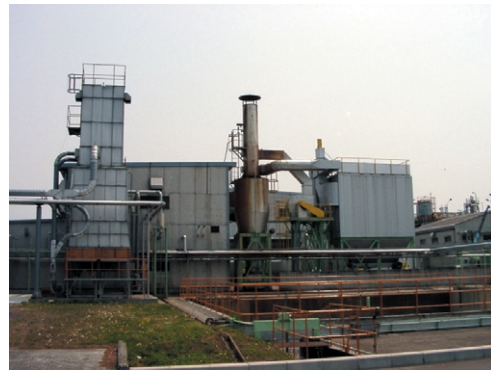
東北工場 木屑焼却熱回収施設
