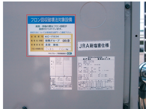
空調室外機に貼った管理ステッカー
